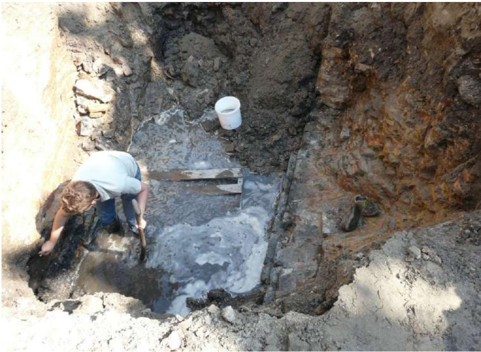
De Grebbe tijdens het graafwerk. Al snel stond er bijna een meter water in.
