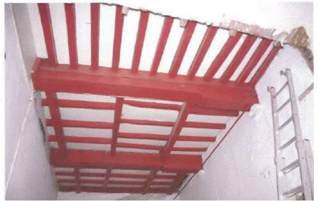
Een overzicht van de verdiepingvloer, vanaf de begane grond in de richting van de voorgevel. Op de voorgrond een authentiek balkvak met kinderbinten.
